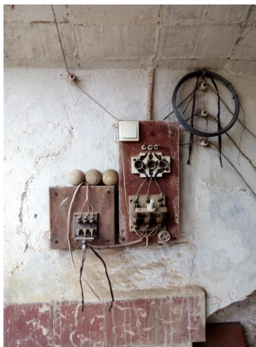
Il·lustració 19: Interruptors de la bomba perquè l'aigua pugés al dipòsit
